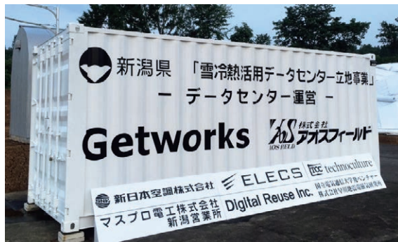
▲新潟県「雪冷熱活用データセンター立地事業」へ参加 冬に貯雪、夏にサーバ約60台を冷やす空調熱源として雪を活用 (平成28年6月より津南町にて稼働中)
